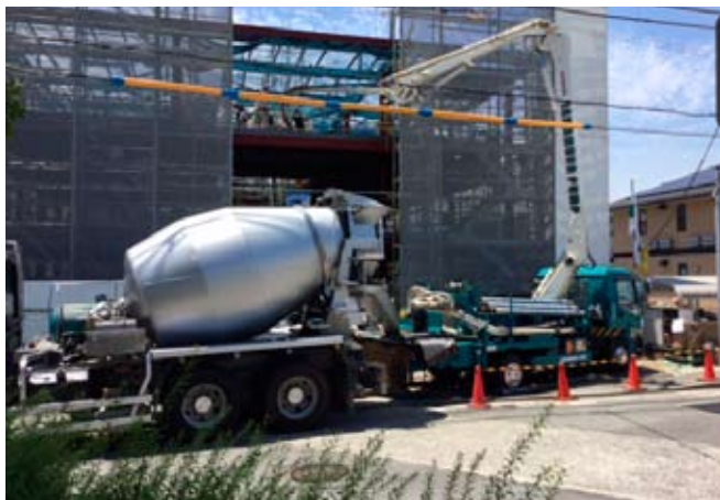
6月9日。床スラブ（床構造をつくり、面に垂直な荷重を支える板の部分）のコンクリート打設。
